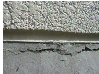
外壁の亀裂 建物内外のあちらこちらに大きな 亀裂や壁面の落下がありました
