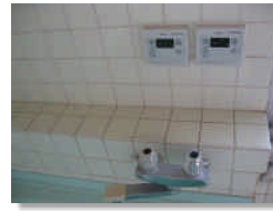
給湯器改修 追い焚きができます。
